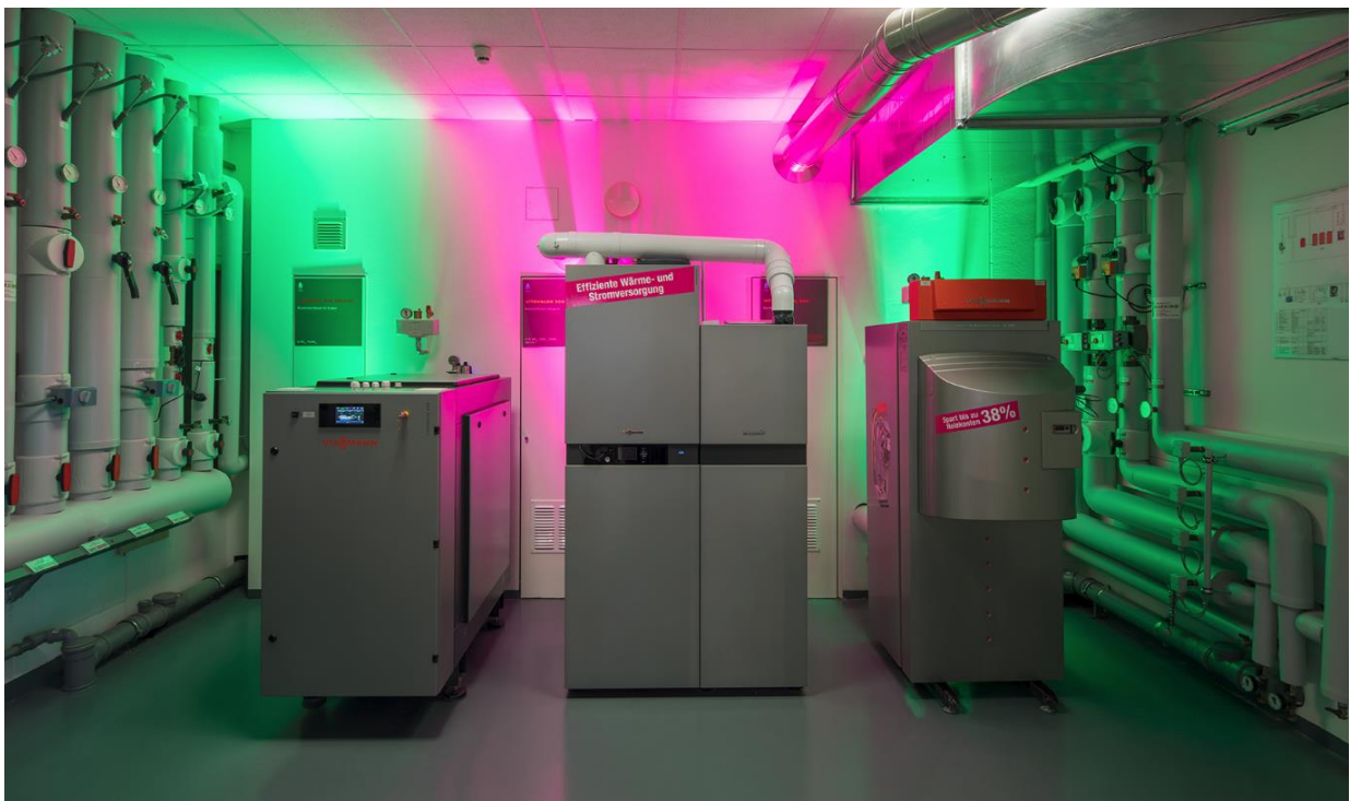
Abbildung 4.6 Installation in der internen Heizzentrale [1]
