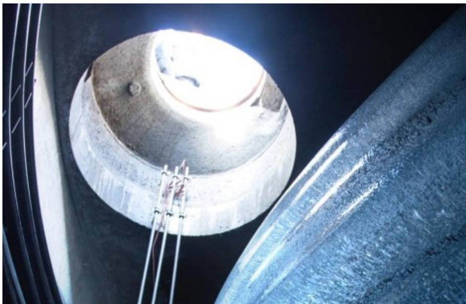
Abbildung 25 Innenansicht eines gefrorenen Eisspeichers (Quelle: Viessmann)
