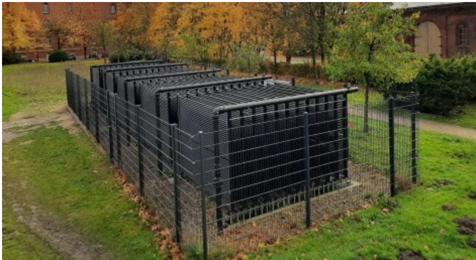
Abbildung 11 Energiezaun in Blockaufstellung (Quelle: Viessmann)
